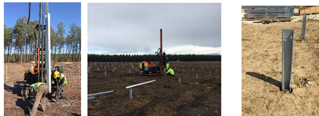
Figure 89 : Exemples de mise en place des pieux battus sur les chantiers (source : URBASOLAR, 2022)
