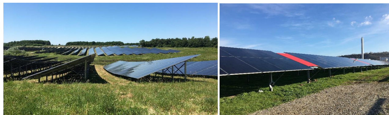
Figure 79 : Exemples de réalisations Urbasolar : Nersac (16) et l'Oncopole de Toulouse (31) (source : URBASOLAR, 2022)
